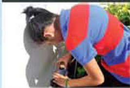
Perbaiki Kebocoran Segera
